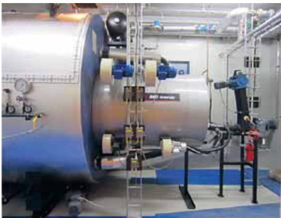
Pannan från MW Power levererades komplett i container till Bubs Godis i Jönköping.
